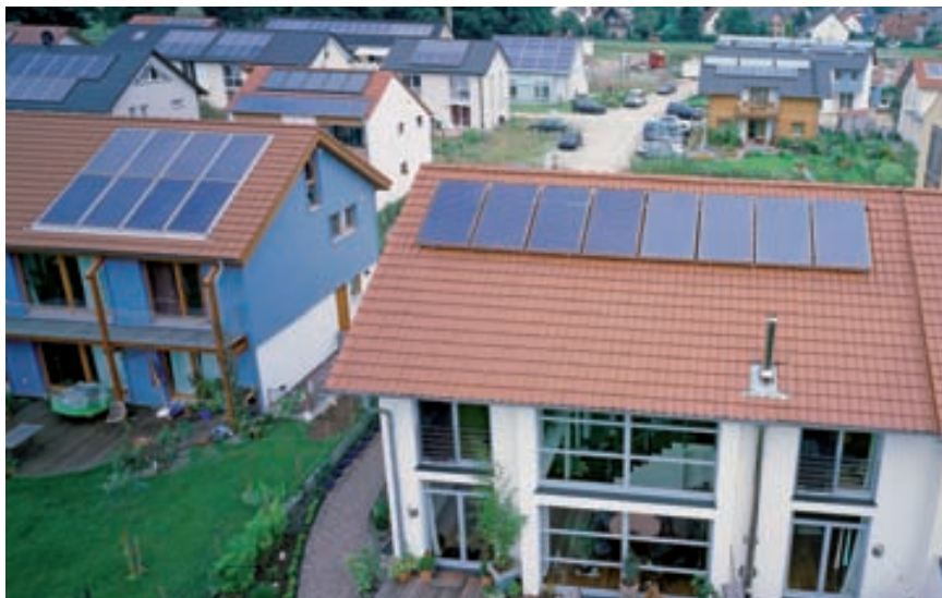
Abb. 2: Sonnenkollektoren für die Wärmeerzeugung (Solarthermie)
